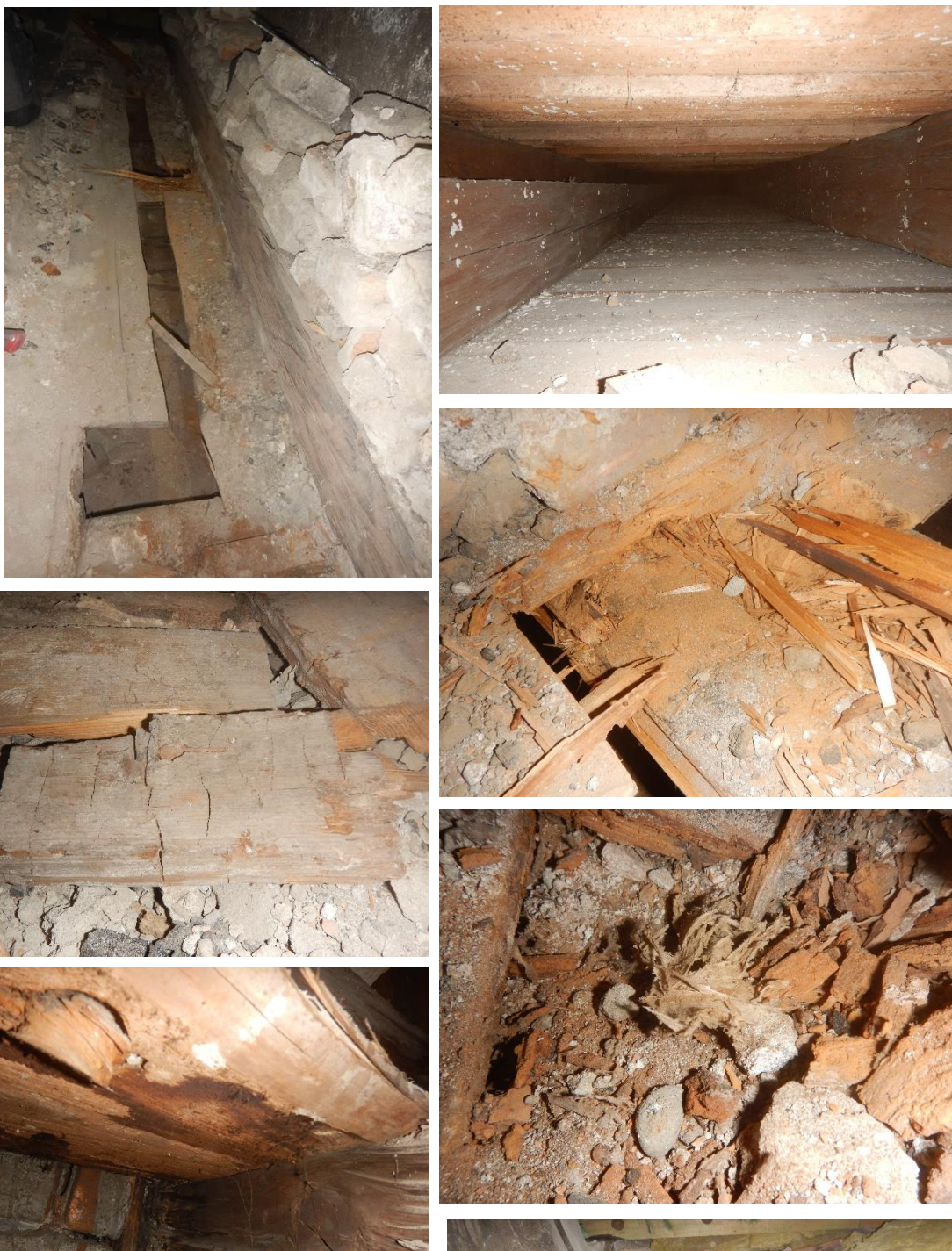
Foto č. 49-54 - NV37-celkový pohled, detail průběhu trámů ,silného napadení prvků až rozpad záklapu;
