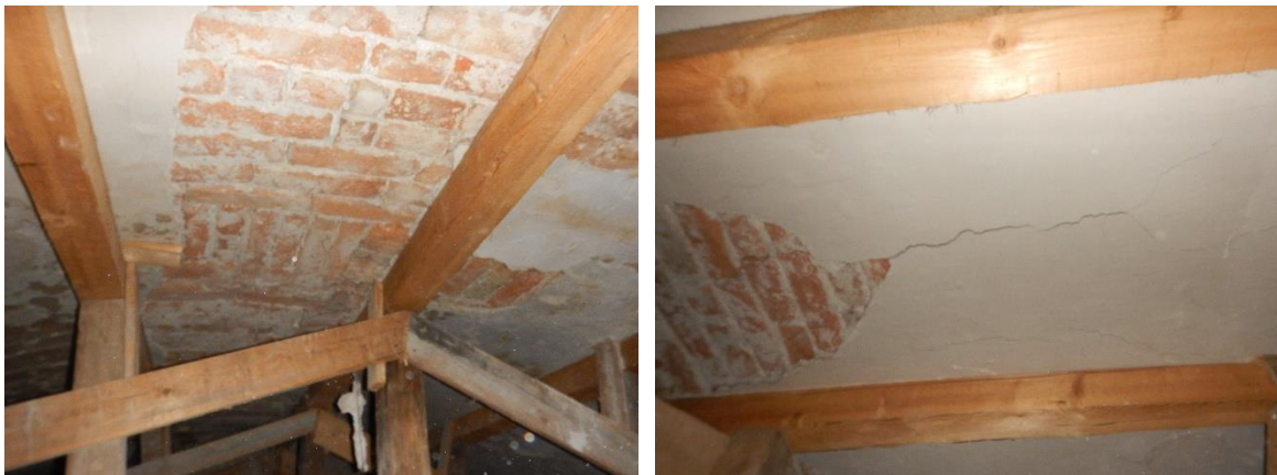
Foto č. 33;34 - NV32- poškození cihelné klenby;
