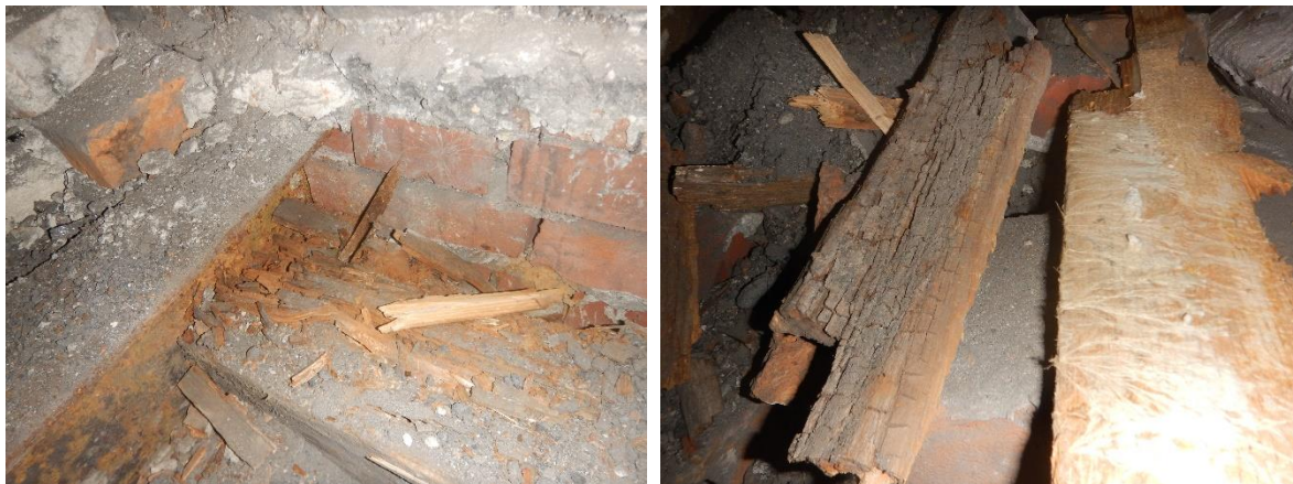
Foto č. 58-61 – NV39-celkový pohled,průběh trámu,detaily rozpadů prvků vlivem napadení dřevokazných činitelů
